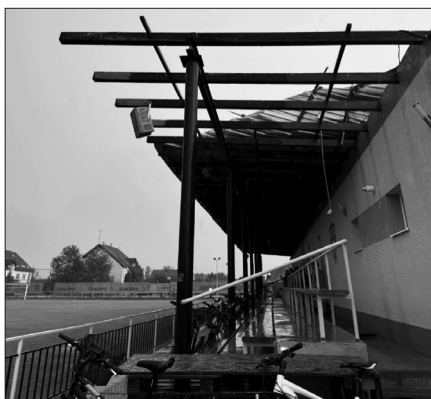
Zničená strecha na budove na futbalovom ihrisku
